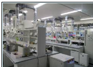
可変局所排気装置付試験室
