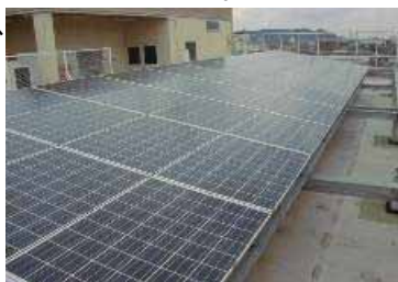
あい愛プラザの太陽光発電パネル 富岡市(環境課)で設置
