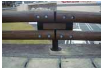
東吾妻町の木製ガードレール
